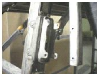
図 1 欠損したリベット接合
